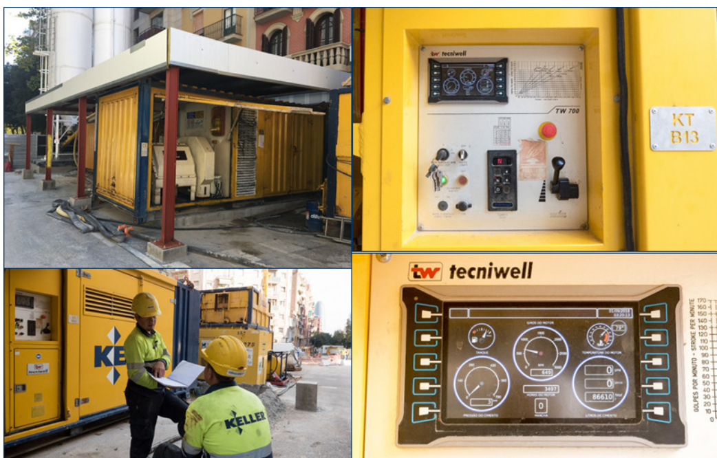
Figura 9. Instalaciones de las bombas y plantas en estructuras tipo contenedor.
